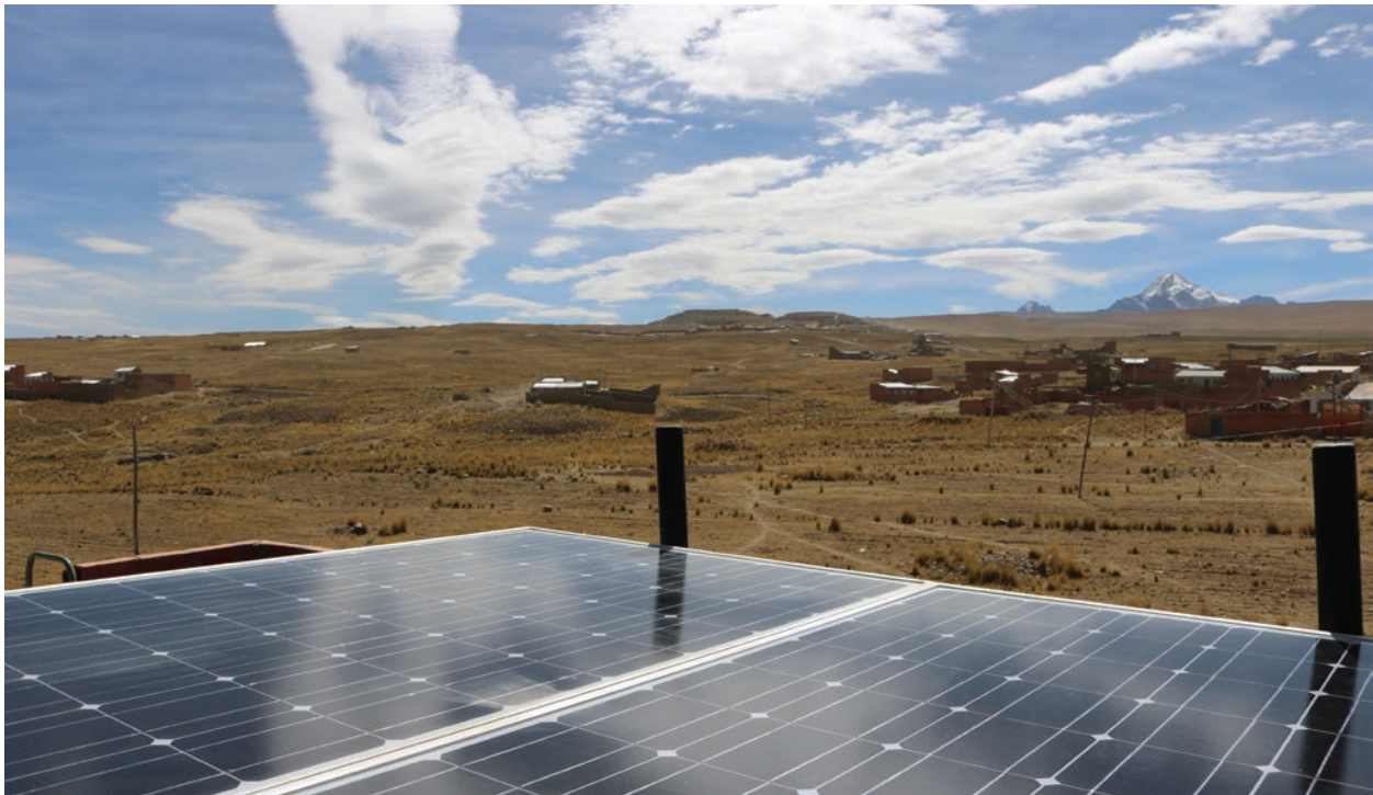
Sistema de paneles solares para la generación de energía en el relleno sanitario El Ingenio.
